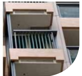
工作平台 Utility Platform
