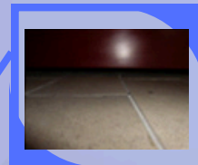
沒有過大縫隙 No excessive gap
