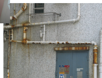
排水管 / 潔具出現裂縫或銹水漬
