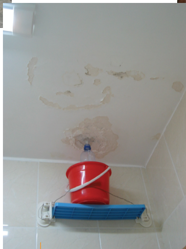
室內地方的天花滲漏
