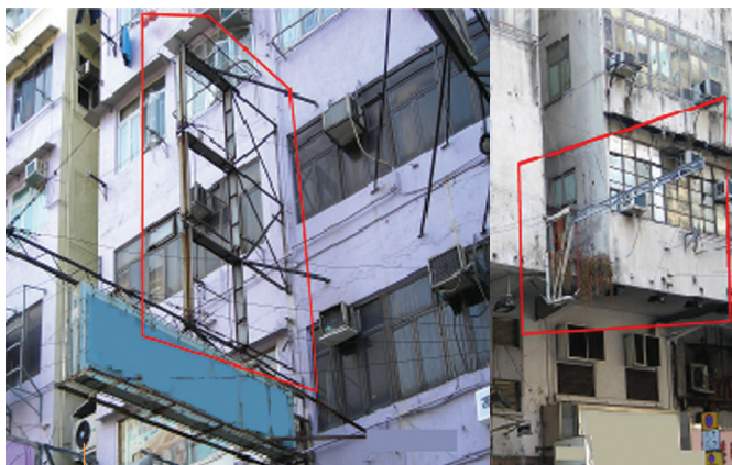
招牌 / 招牌顯示面已被拆去，只遺下招牌支承鐵架
