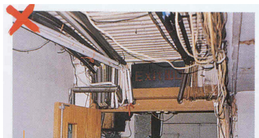
樓梯內的電纜沒有妥善的防火保護
