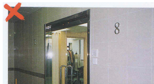
開向公用走廊的門耐火能力不足
