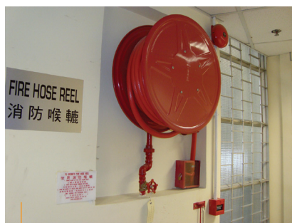
消防栓及喉轆系統
