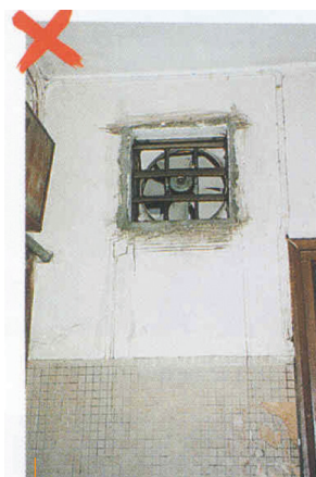
擅自在隔火牆上開設 通口並安裝抽氣扇
