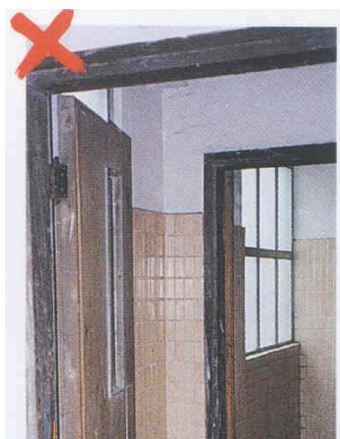
消防門損毀或遭拆掉
