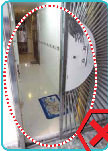
樓宇單位原有入口的防火門被拆除，令各分間單位之間的走廊直接通往出口樓梯/防煙門廊
