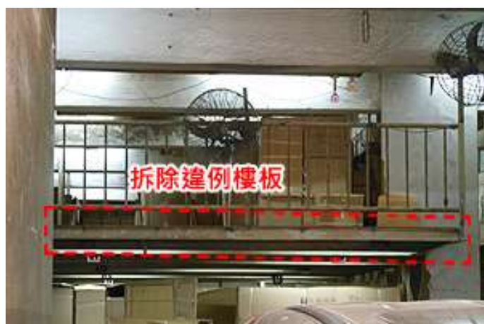
第 1.39 項 拆除違例樓板
