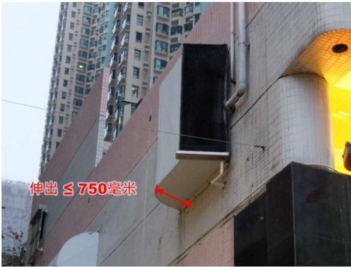
第 1.47 項 豎設或改動外牆的室外金屬通風管道或相關的承托支架
