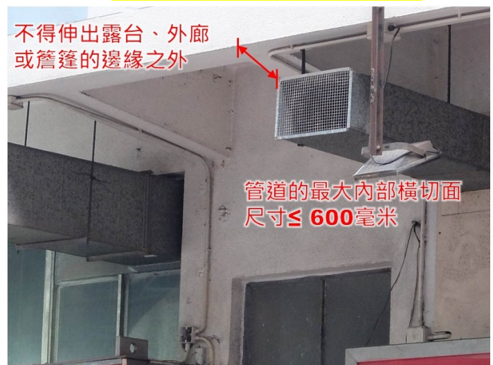
第 3.48 項 豎設或改動懸掛於露台底部之下的室外金屬通風管道或相關的承托支架
