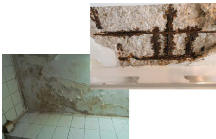
防水層不足或破損可導致滲水及結構構件剝落
