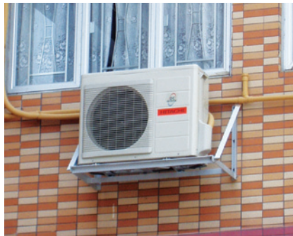
空調機的承托支架
