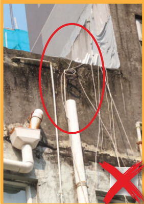
通風管未有延伸至樓宇天台之上不少於一米的高度
